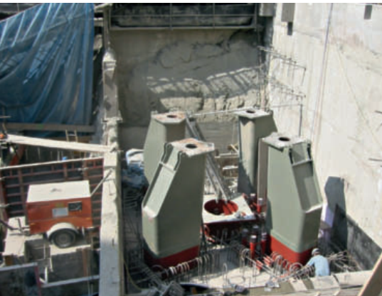
3 Stützen der MVR 1800 C-4 bei Hauri in Bötzingen/Deutschland
