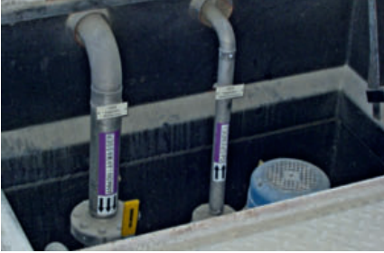
6 Leitungen zur Beschickung einer Rauchgasentstickung mit ammoniakhaltiger Lösung (hier SNCR-Anlage)
