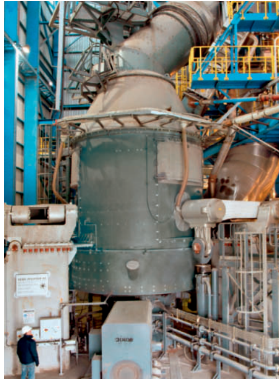
5 Die MVR 3750 R-3 im Werk Lukavac (Bosnien-Herzegowina) nach der Inbetriebnahme
