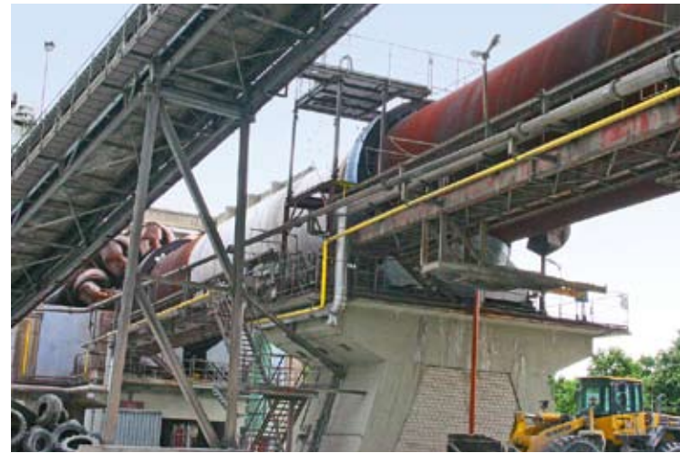
6 Rotary kiln with satellite cooler • Drehofen mit Sattelitenkühler
